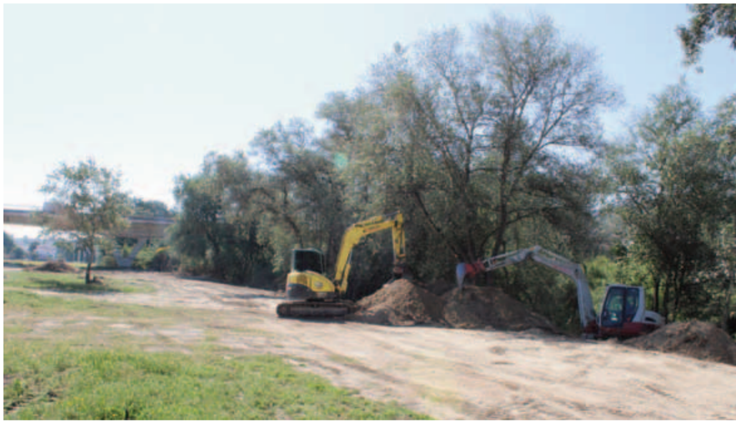
Estas primeras semanas la maquinaria pesada trabaja en el movimiento de tierras en el margen del río Genil entre los dos puentes. FOTO: C. MOLINA
