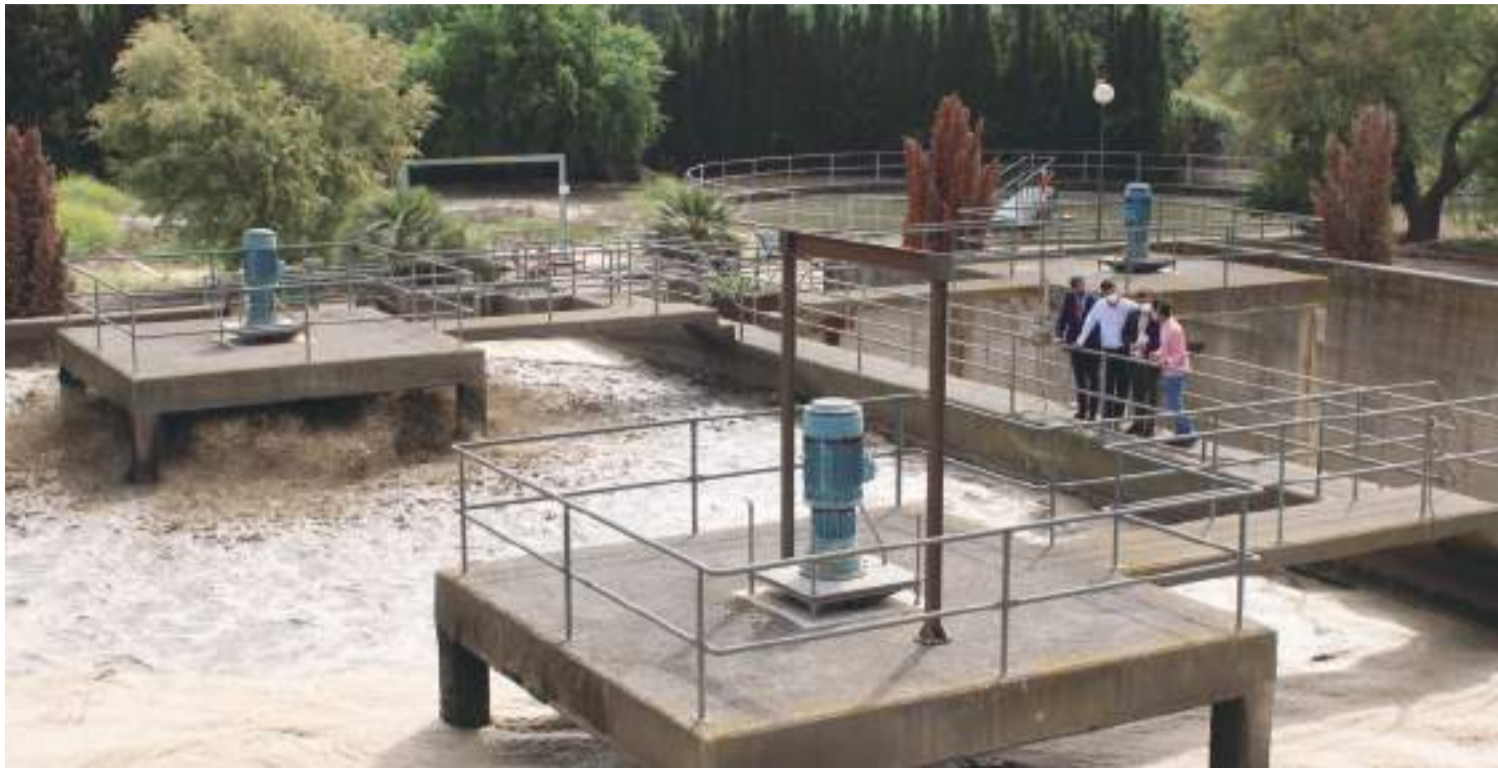
El alcalde y el concejal de Urbanismo visitan las instalaciones de la depuradora, acompañado s de técnicos y responsables de Gemalsa. FOTO: C. MOLINA
