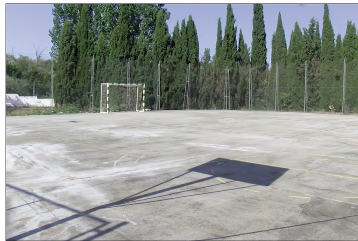
Estado de la pista deportiva de Riofrío, lugar de la actuación. EL CORTO
