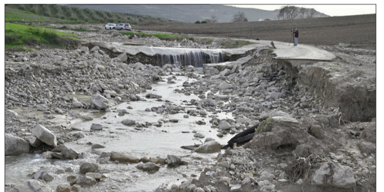
Estado en el que ha quedado el Camino de Los Gallumbares. C. MOLINA.
