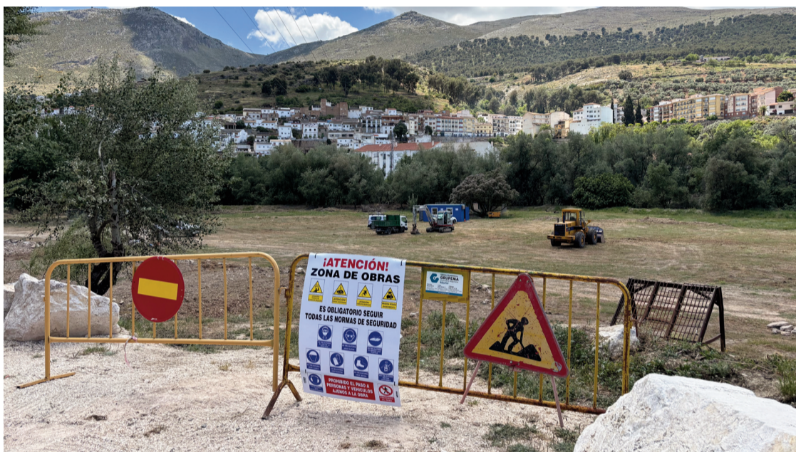
Las obras de la segunda fase del Paseo del Genil han comenzado con la retirada de escombros. FOTO: ALBERTO A. MATAS
