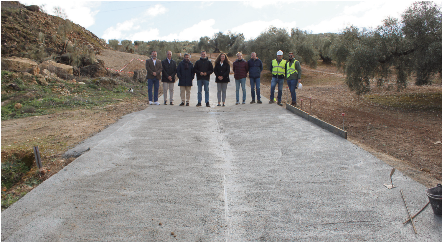
Las autoridades visitan el estado de los trabajos que se realizan en el camino de la Cañada Real. FOTO: C. MOLINA
